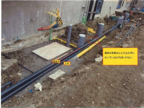
誤接続箇所配管状況
